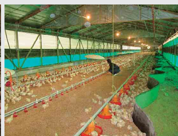
暖房器具の点検 (燃料切れの有無や適切な燃焼状態の点検)
