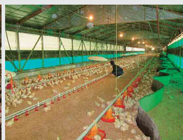
暖房器具の点検 (燃料切れの有無や適切な 燃焼状態の点検)
